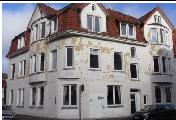
bauliche Mängel an ortsbildprägendem Gebäude
