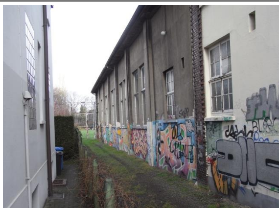
verschlossener Zugang mit funktionalen/gestalterischen Mängeln
